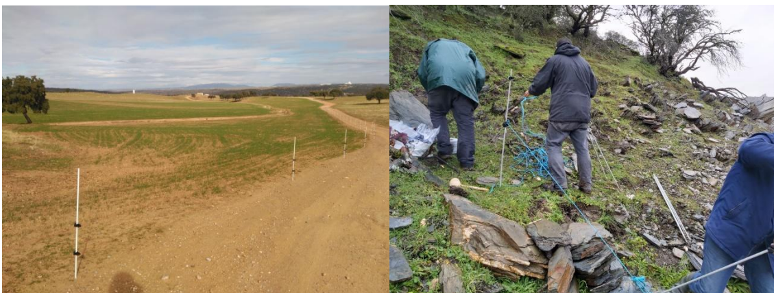
Instalación de pastor eléctrico en la finca Vando (Casar de Cáceres).
